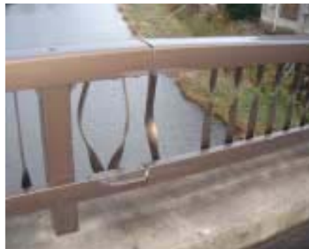
防護柵の破損
