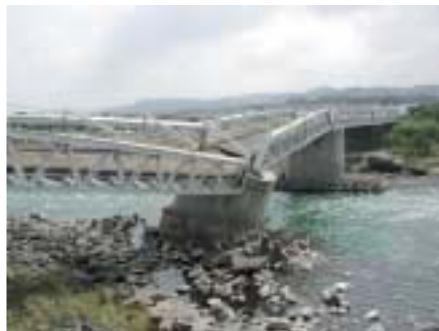
洗掘による橋脚の転倒
