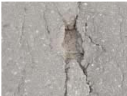
舗装のポットホール
